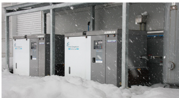
製造工場 SMS15SD×2台
